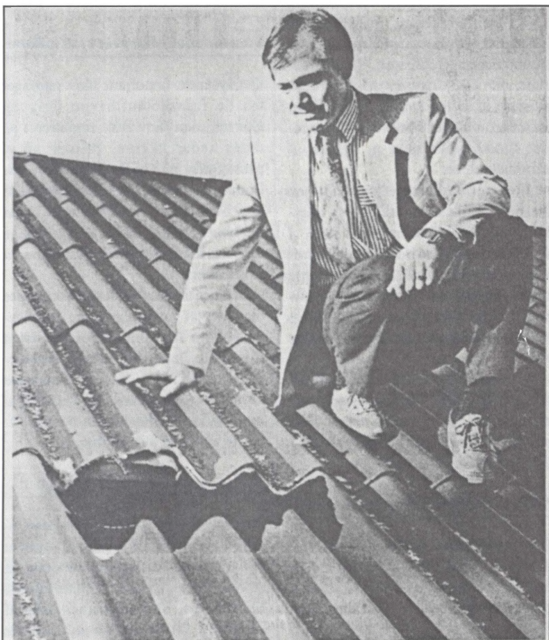
En isblok fra en flyvemaskine gennemhullede tirsdag taget til en udstillingsbygning hos autoforhandler Bjarne Hansen, Ringe. Her besigtiger han ødelæggelsen - et hul på 40 x 50 cm. (Foto: Fyns Presse Foto)
